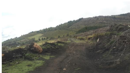
Superficie de rodadura deteriorada
