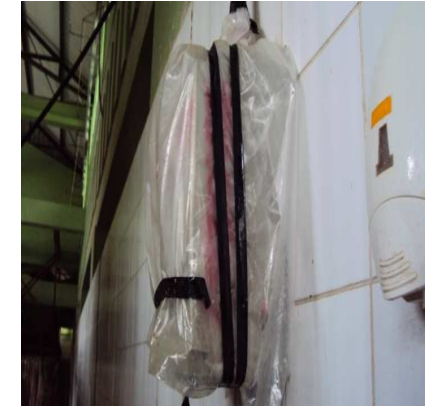
Seguridad del panel de control
