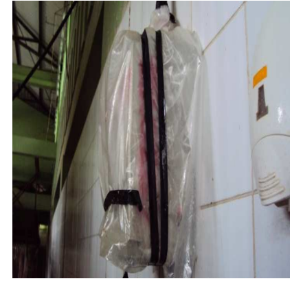
Seguridad del panel de control
