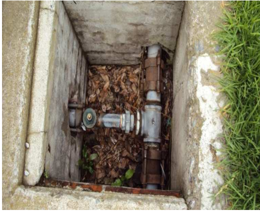
Medidor de agua
