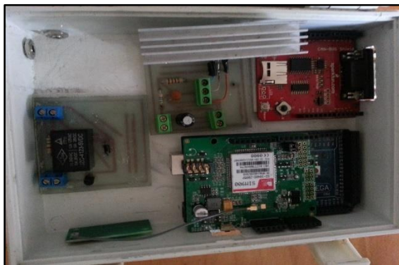
Fig. 4.38 Colocación del Circuito de Control. Elaborado por: David Chávez
