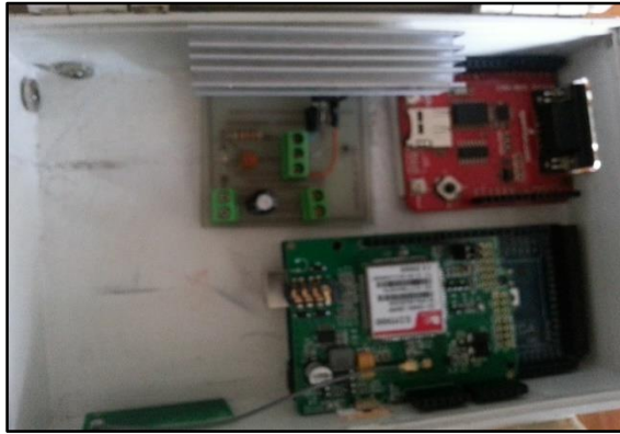
Fig. 4.37 Colocación del Circuito Regulador de Voltaje Elaborado por: David Chávez
