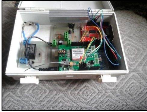
Fig. 4.40 Vista del cableado interno del sistema posteriormente
