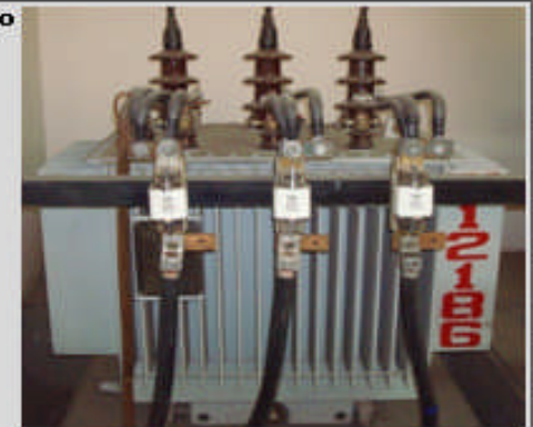
Gráfico A15 Información Técnica del Transformador de Energía Eléctrica en Casa de Máquinas en el Hospital del IESS de Ambato.
