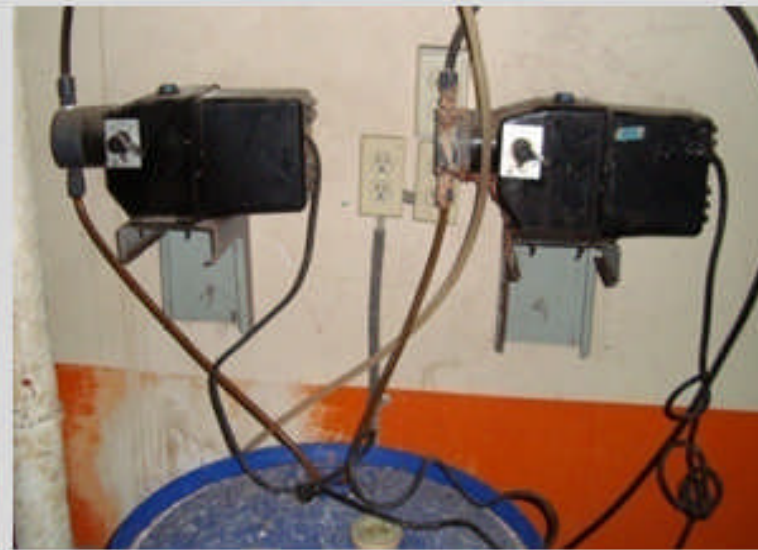
Gráfico A6 Información Técnica de las Bombas Dosificadoras de Químico para Calderos en Casa de Máquinas en el Hospital del IESS de Ambato.
