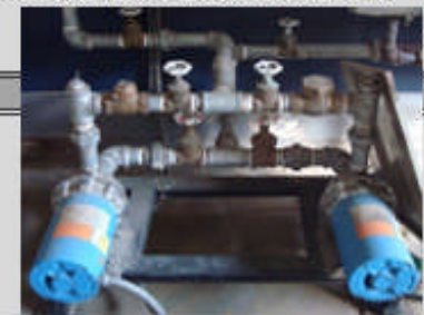
Gráfico A9 Información Técnica de las Bombas de Recirculación de Agua Caliente en Casa de Máquinas en el Hospital del IESS de Ambato.
