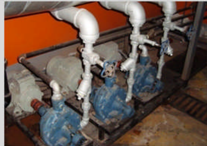
Gráfico A5 Información Técnica de las Bombas que suministran agua a los Calderos en Casa de Máquinas en el Hospital del IESS de Ambato.
