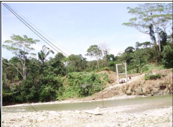
Cruce de cables de torre a torre
