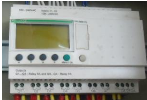
Figura 6.10 Controlador Lógico Programable (PLC) Fuente: Autor
