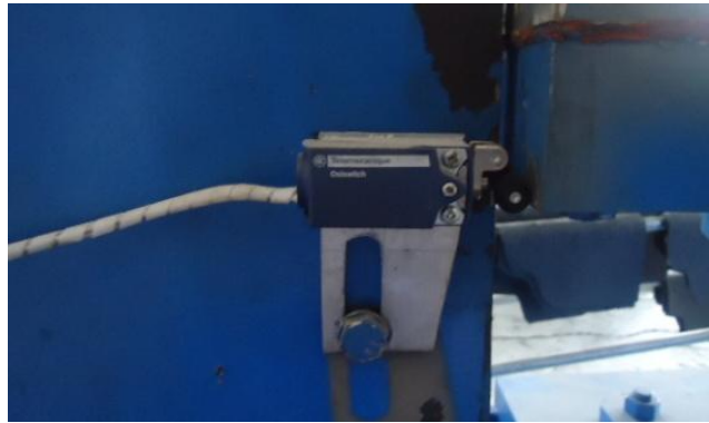
Figura 6.25 Conexión de los Finales de Carrera
