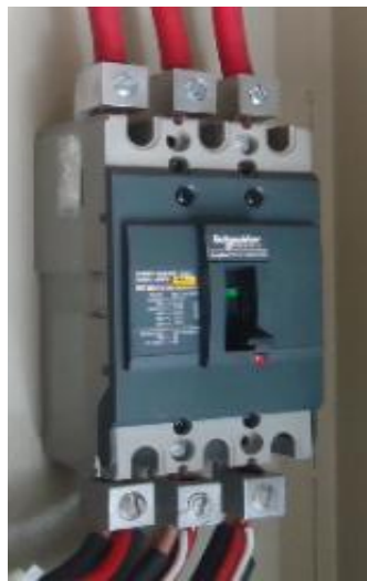
Figura 6.4 Breaker Fuente: Autor
