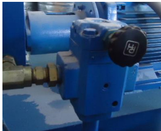
Figura 6.3 Válvula de Alivio RF-T04 Fuente: Autor
