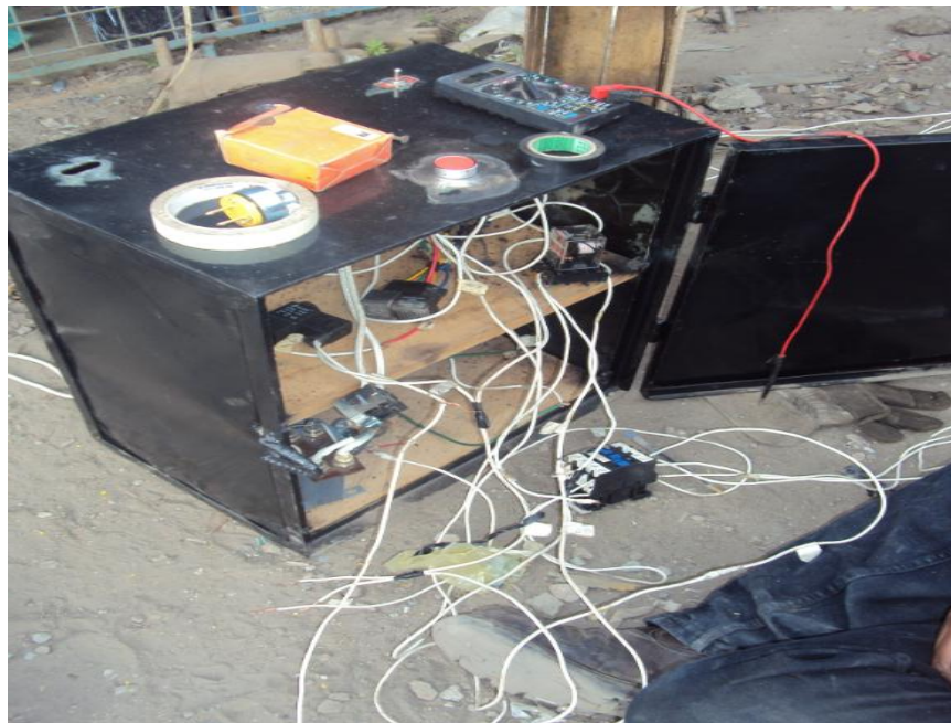
Imagen 10 Conexión de Equipos Eléctricos Fuente: Egdo Daniel Núñez
