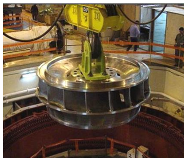
Figura 2.1 Rodete de una Turbina de la Central Hidroeléctrica Agoyán ( www.hidroagoyan.com )
