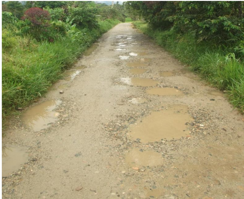
Gráfico N°28. Capa de rodadura deteriorada
