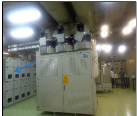
d) Mantenimiento de Centro de Carga de Casa de máquinas CCCM
