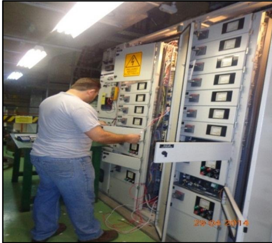
e) Mantenimiento del CCM
