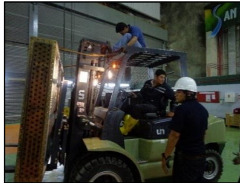
j) Traslado de los radiadores del piso de maniobras hacia la chimenea de equilibrio inferior
