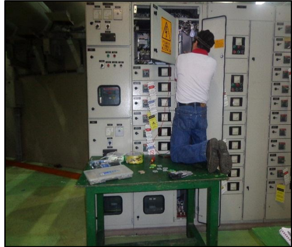
f) Tablero TSE (sistemas esenciales)
