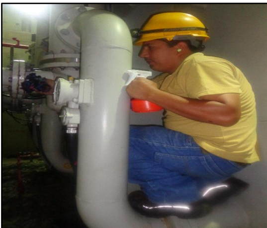
c) Mantenimiento del transformador principal
