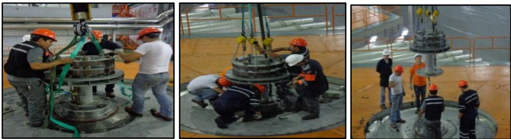
g) Desmontaje de los anillos de las escobillas
