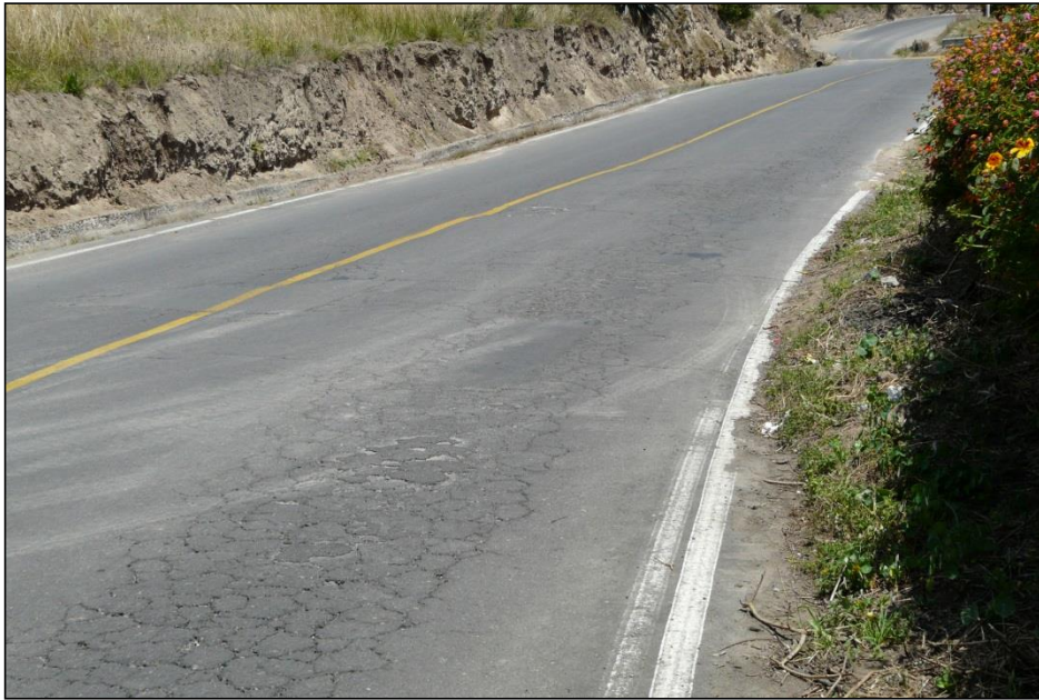
Abscisa 0+800m. Desprendimiento de capa de rodadura.
