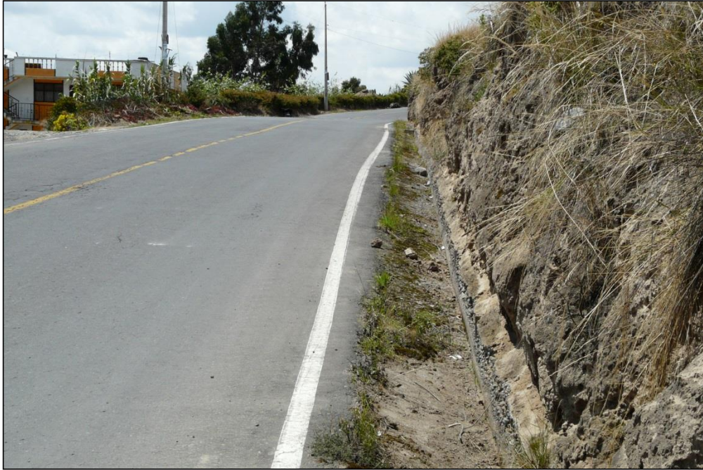
Abscisa 1+600m. Estado de cuneta.
