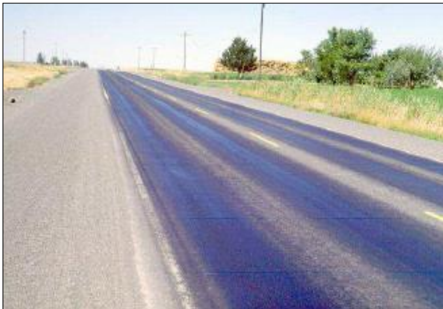
Gráfico 15 Exudación de asfalto.
