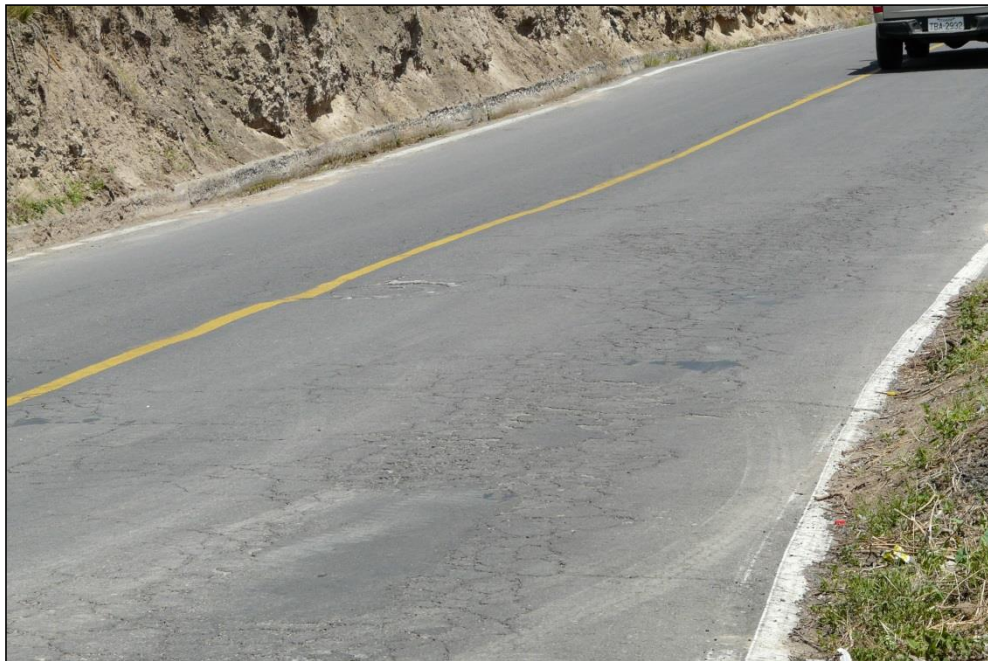
Abscisa 1+150m. Desprendimiento de capa de rodadura.
