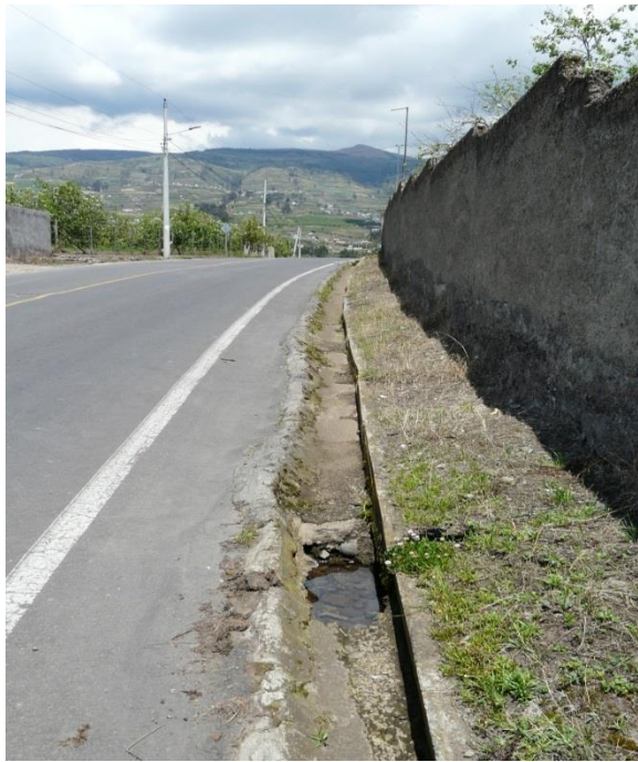
Abscisa 2+800m. Estado de cuneta.
