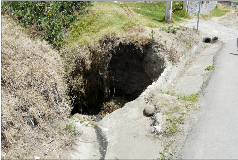
Abscisa 3+600m. Falta de alcantarillas.
