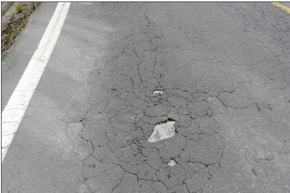
Abscisa 1+950m. Desprendimiento de capa de rodadura
