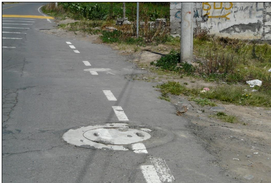
Abscisa 0+350m. Fallas en construcción de bermas
