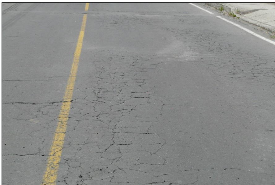
Abscisa 0+100m. Fallas en la capa de rodadura
