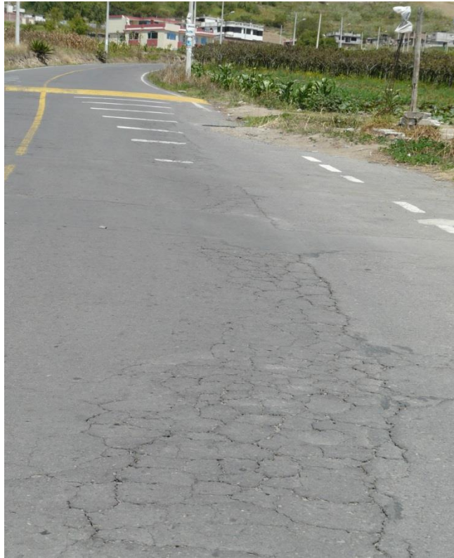
Abscisa 0+150m. Fallas en la capa de rodadura y hundimientos
