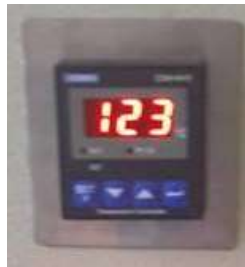
Figura 6.9: Control de temperatura digital
