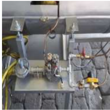
Válvulas del quemador
