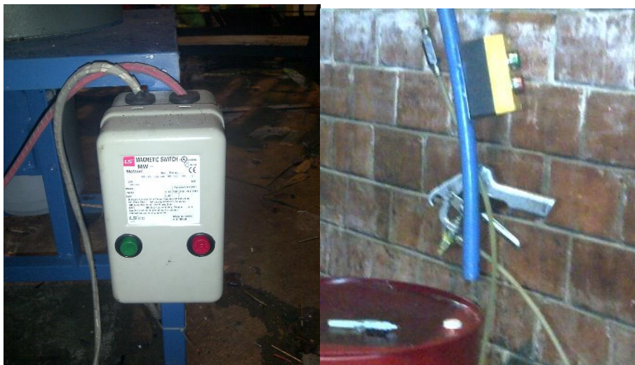
Figura 6.20: Instalación eléctrica FUENTE: Roberto C. Panimboza C. (Autor)
