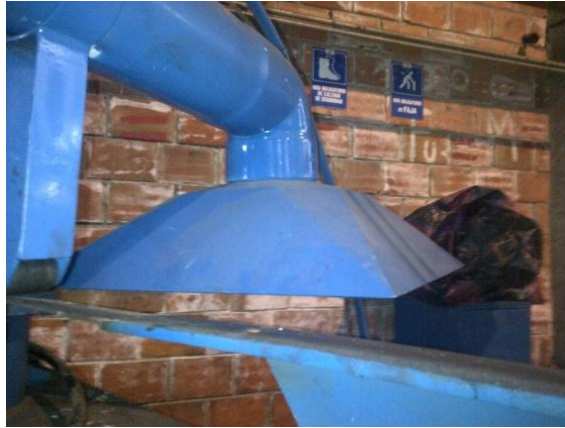
Figura 6.19: Ensamble del ducto y la campana FUENTE: Roberto C. Panimboza C. (Autor)
