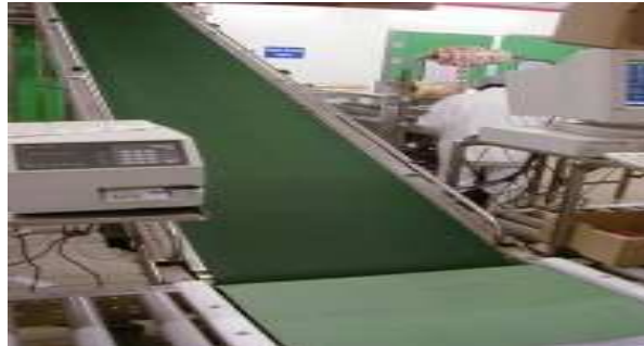
[Figura #87]: Elevadores a Banda 72
