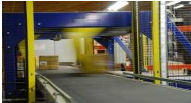
[Figura #85]: Banda transportadora con ángulo de inclinación 70
