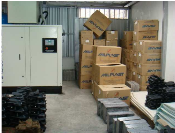
Figura 21: Desorden de las Instalaciones: Cuarto de Tablero de Control y Compresor
