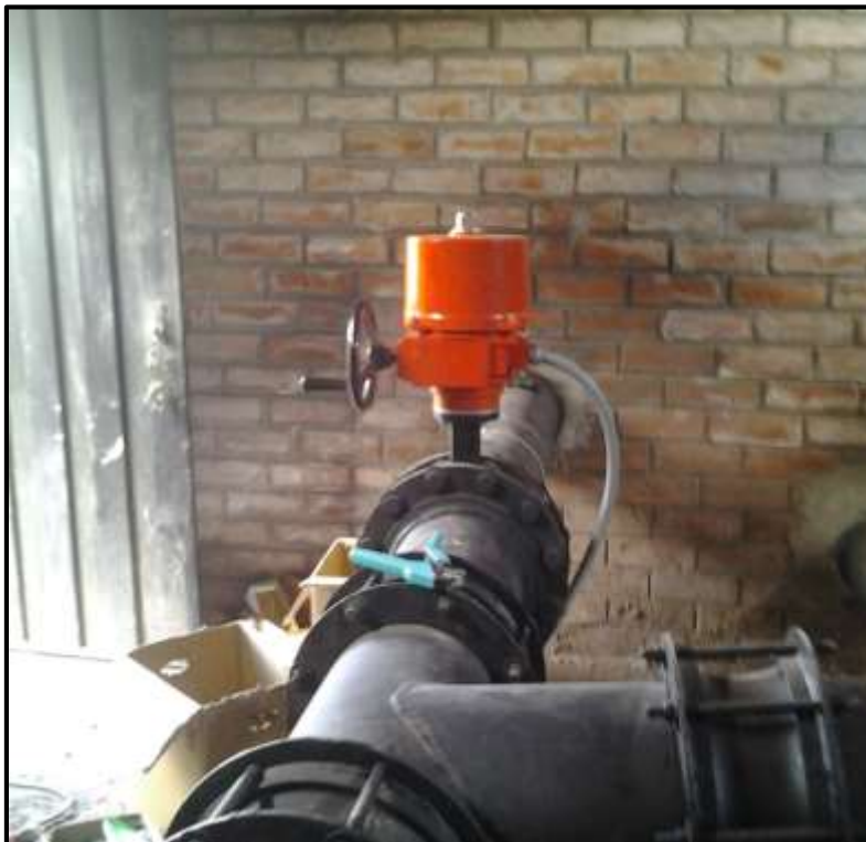
Figura 4.42 Válvula de salida Tanque Los Pinos
