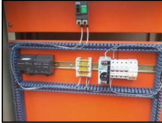
Figura 4.64 Alimentación tablero el Panecillo
