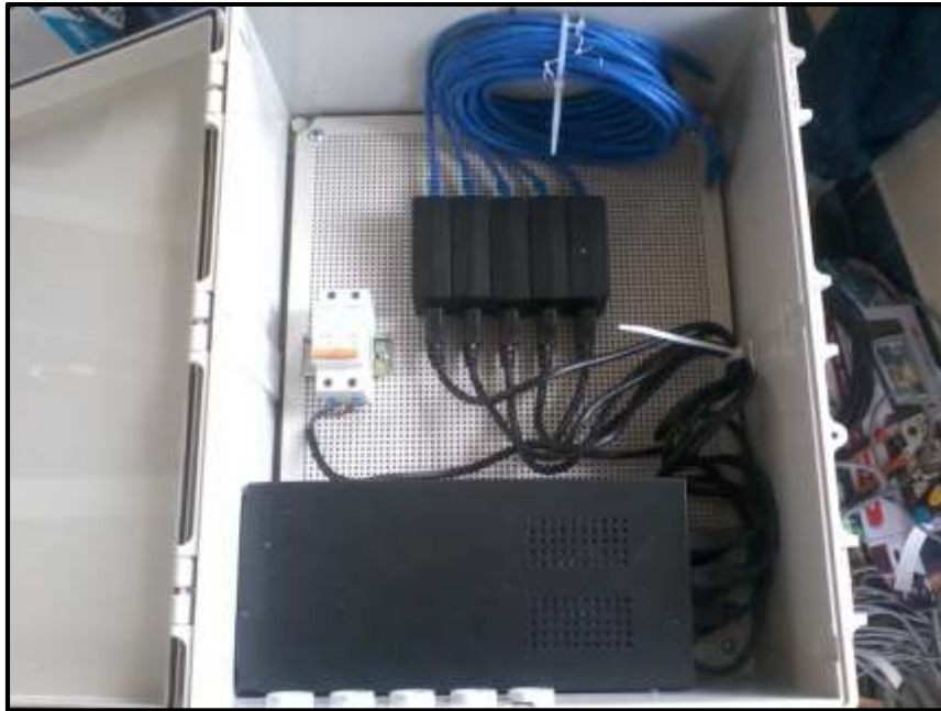
Figura 4.86 Tablero de Comunicación repartidora El Tablón
