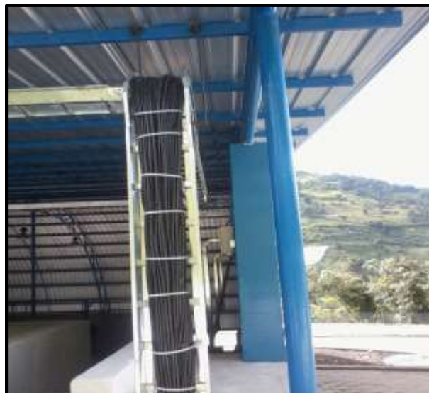
Figura 4.68 Cableado Planta de Tratamiento 2
