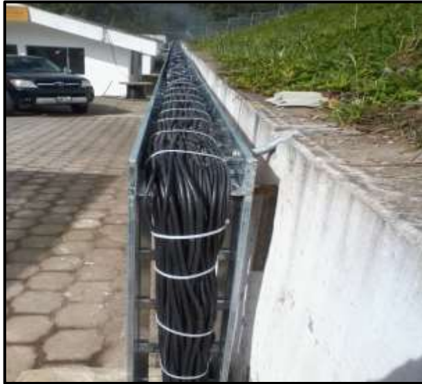
Figura 4.67 Cableado Planta de Tratamiento 1
