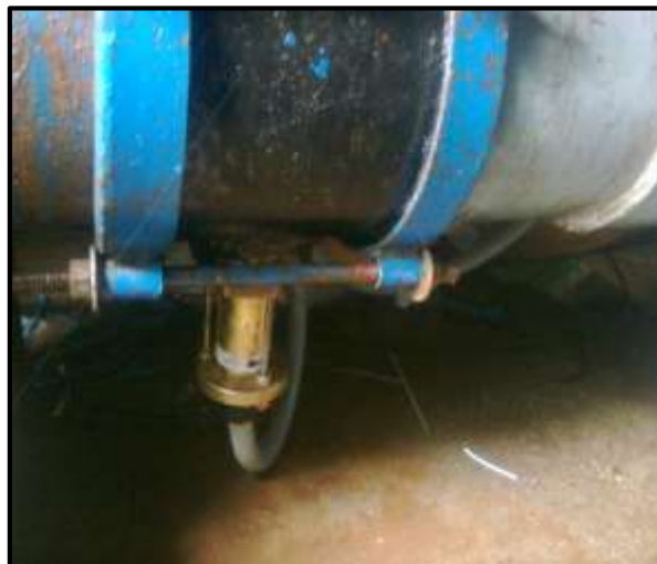
Figura 4.72 Sensor de caudal Captación
