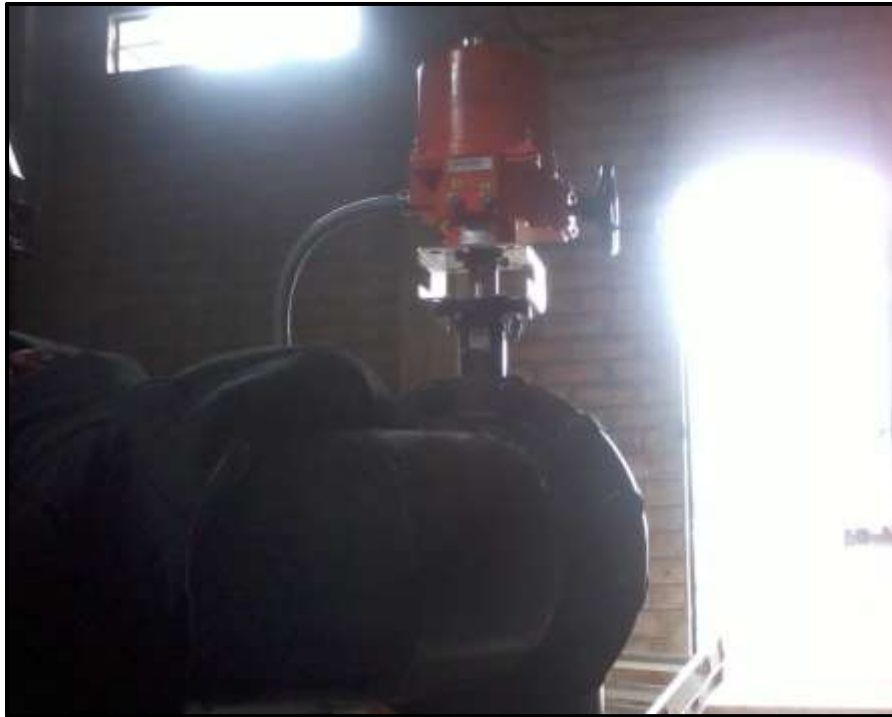
Figura 4.40 Válvula de Salida tanque El Raposal
