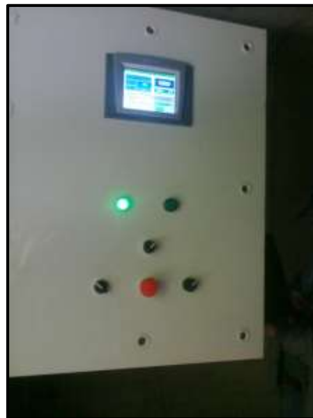
Figura 4.103 Tablero de Captación
