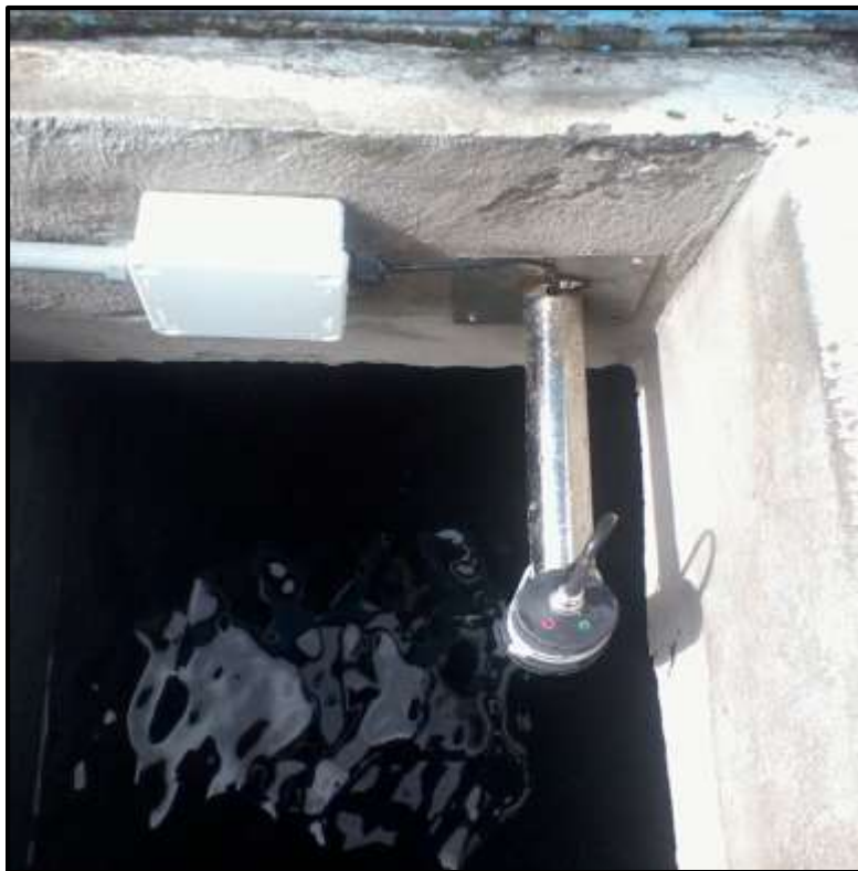
Figura 4.38 Sensor de nivel tanque El Panecillo Fuente: El Investigador
