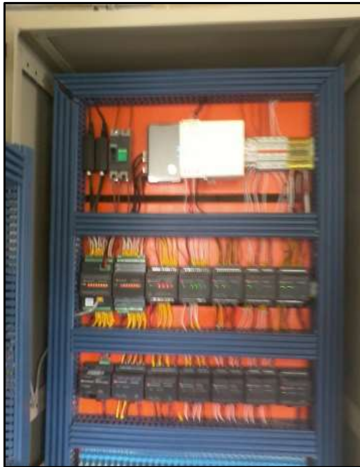
Figura 4.66 Tablero Planta de Tratamiento
