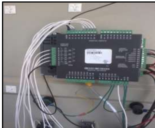
Figura 4.65 Cableado del circuito de control
