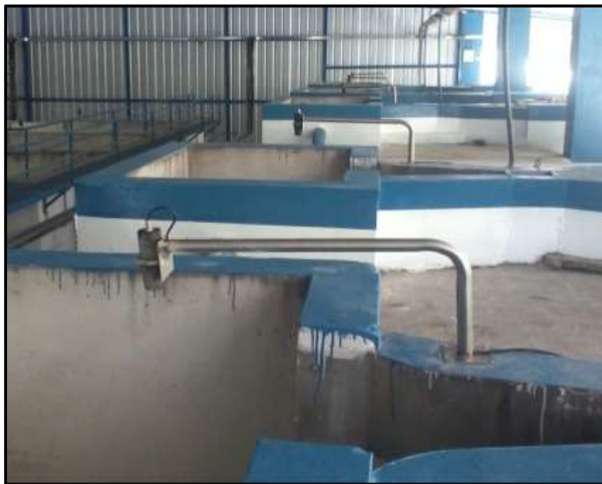
Figura 4.36 Sensores de nivel tanques ciclónicos
