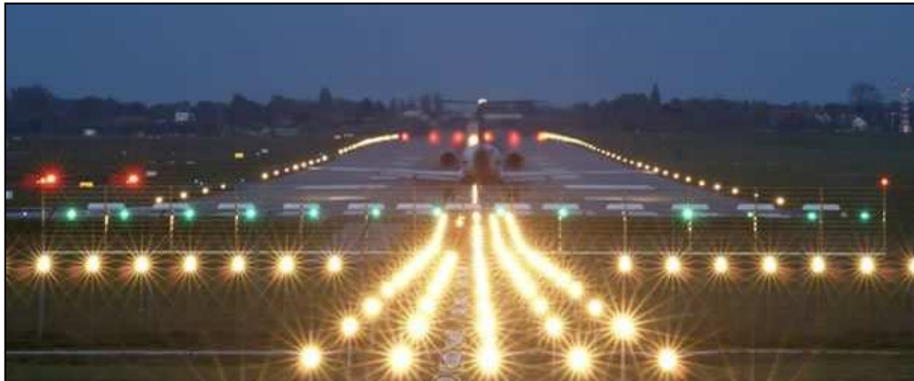
Fig. 2.12: Funcionamiento de la Ayuda Visual iluminada. Fuente. Airpot Lighting. [7].
