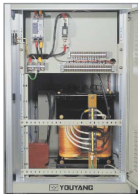
Fig. 4.44: Sección de bajo voltaje
