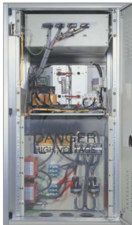
Fig. 4.43: Sección de alto voltaje
