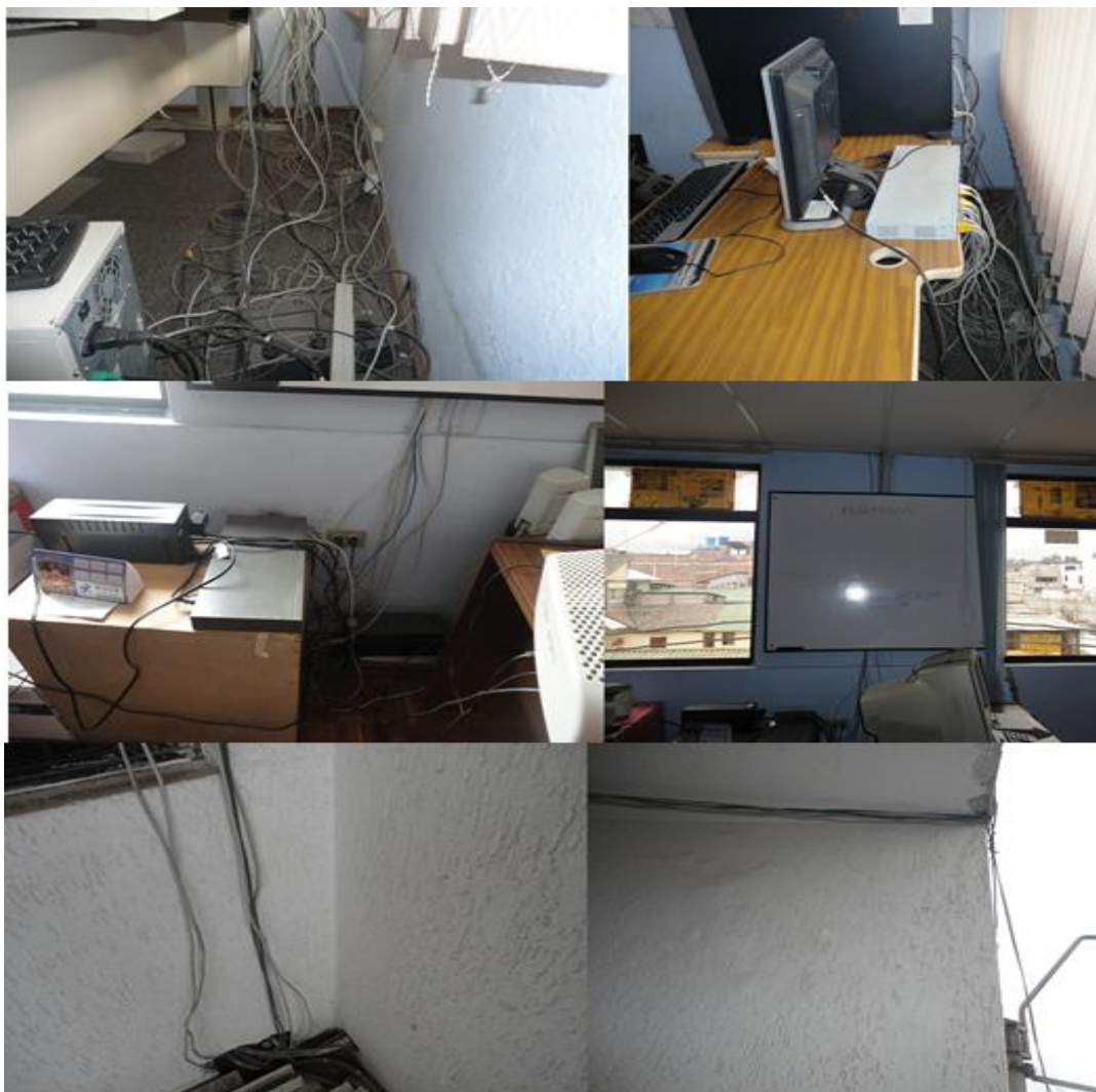
Ilustración 4.2.- Fotografías del Cableado actual.
