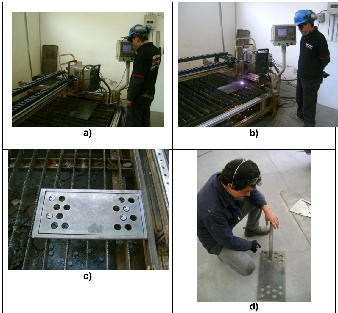
Figura 6.26 a) Corte con CNC de plasma. Seteo de coordenadas. b) Corte con CNC de plasma. Seteo de coordenadas. c) Corte concluido. d) Limpieza de rebabas. Espejo listo para ser instalado
