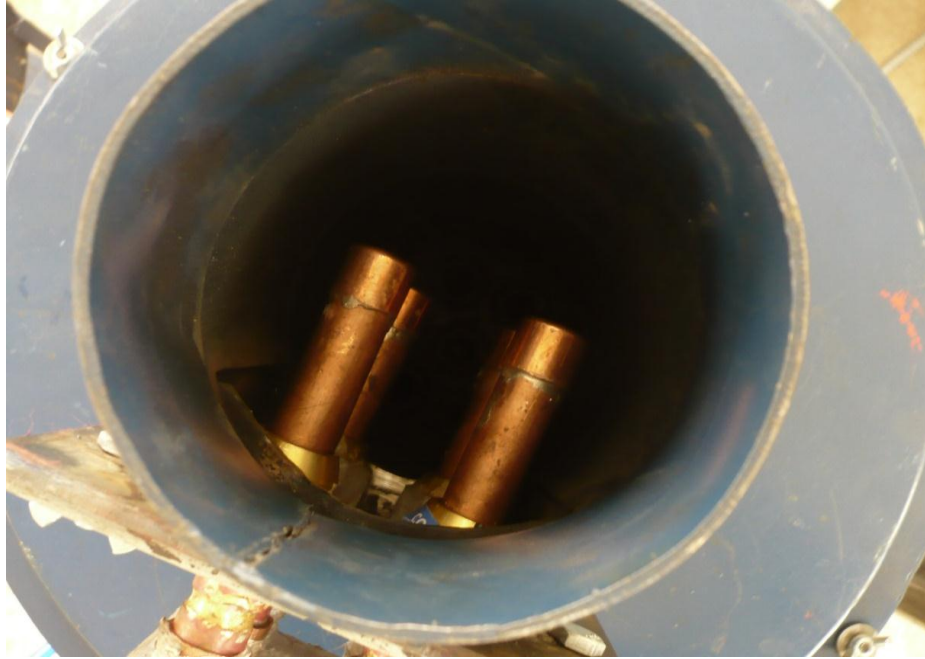
Figura 6. 5 Vista superior del intercambiador de calor instalado dentro de la chimenea del caldero.
