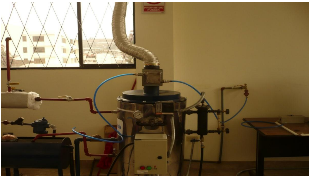
Figura 6. 6 Vista general de la instalación y uso del Intercambiador de Calor en el caldero de la Facultad de Ingeniería Civil y Mecánica.
