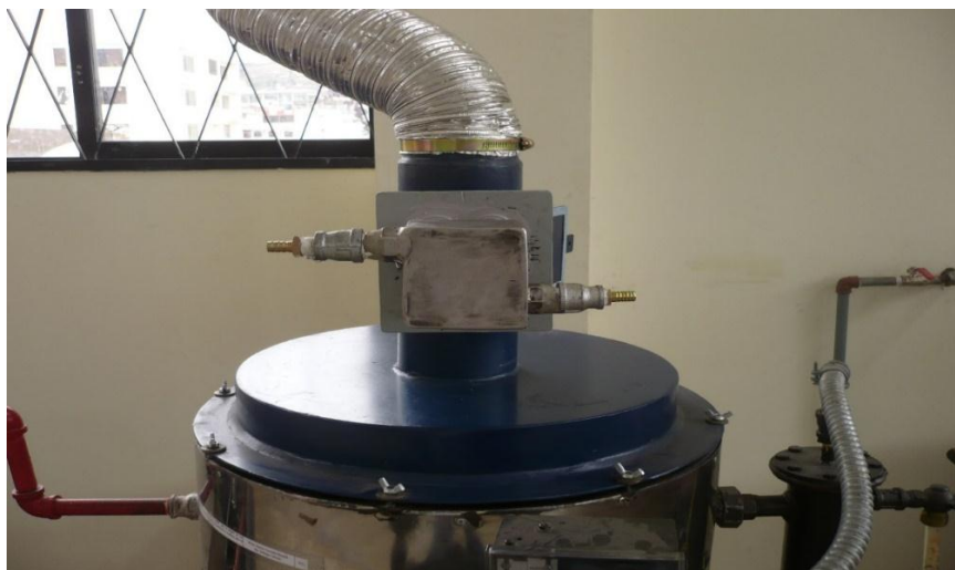
Figura 6. 4 Intercambiador de calor instalado dentro de la chimenea del caldero Elaborado por: Ing. Luis Escobar
