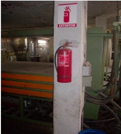
Desnivel del extintor.
