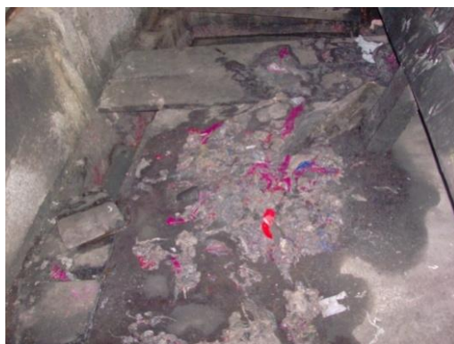
Figura 19: Acumulación de desechos en la Alcantarilla Fuente: El Investigador
