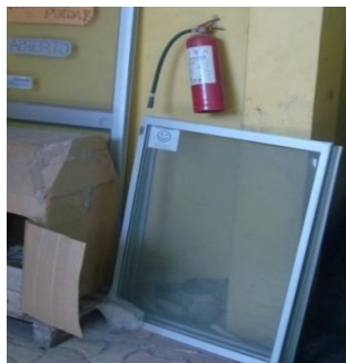
Figura 17: Mala colocación de Extintor y desorden Fuente: El Investigador
