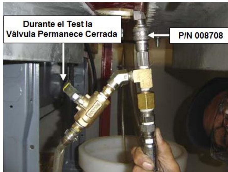
Figura N° 6.6.3.3.1 m) Válvula del manómetro. Elaborado por: La investigadora
