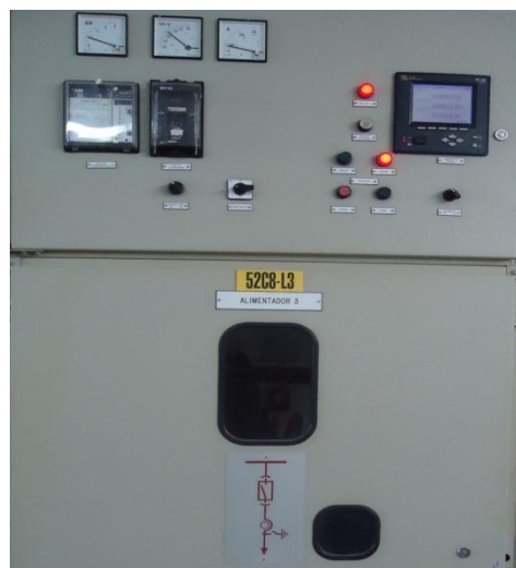
Figura 6.62: Alimentador 3 correspondiente a la zona centro de la ciudad de Latacunga.
