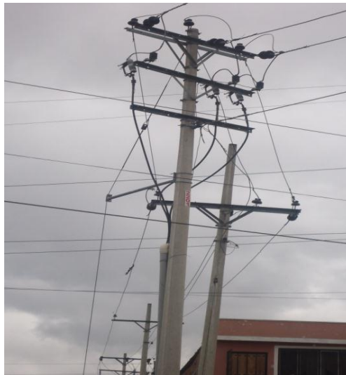
Figura 6.65: Alimentador 3, subestación San Rafael Elaborador por: El Investigador
