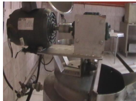
6. Sistema de batido instalado
