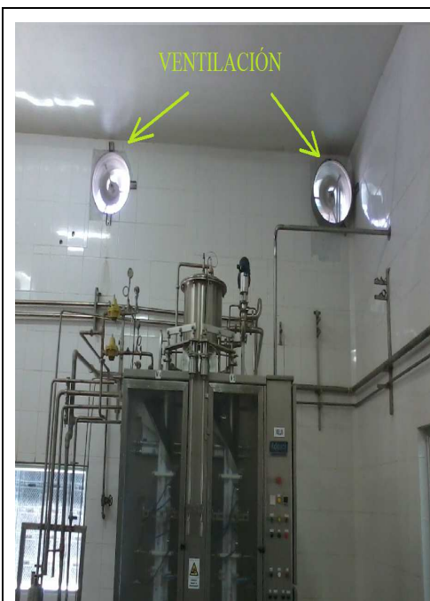
Ventilación Colocada en el Área de Envasado de Leche
