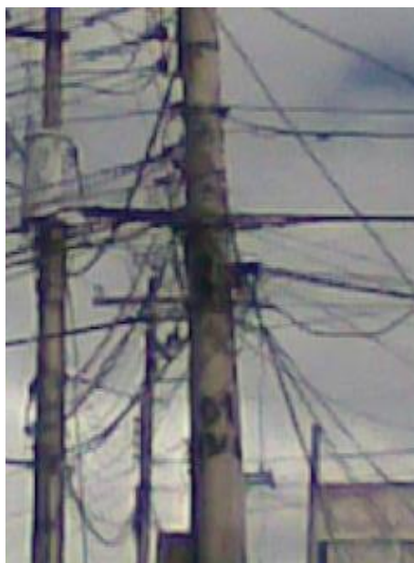
Figura 41. Cables eléctricos y telefónicos juntos en los postes.
