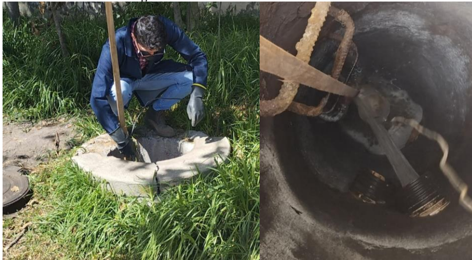
Figura 17. Medición de caudales afluente.
