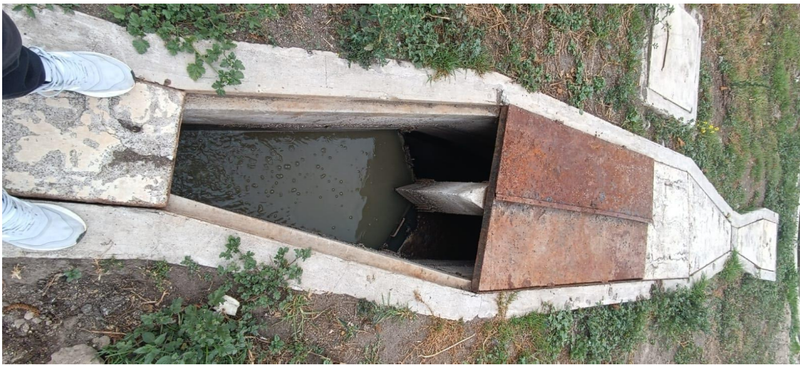
Figura 44. Tapas metálicas deterioradas, y tapas de hormigón (pesadas).
