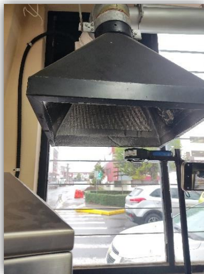
Ilustración N° 07 Medición de velocidad de la campana de extracción
