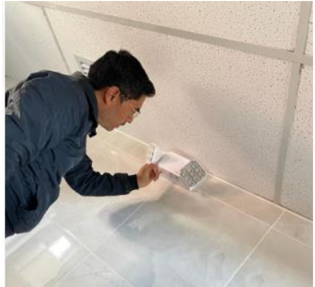
Fotografía 4. Luces de emergencia
