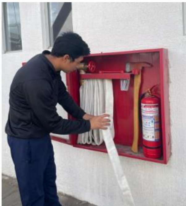
Fotografía 7. Gabinetes de emergencia
