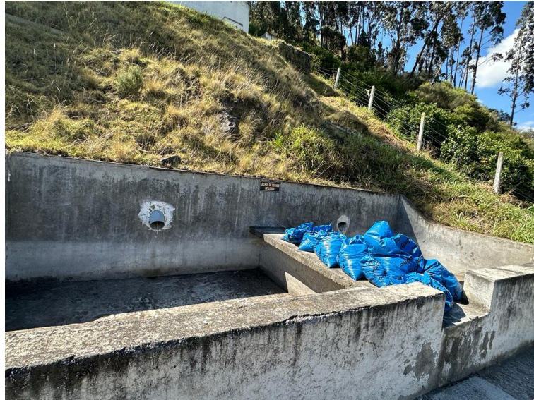
Figura 20. Lecho de secado de lodos.
