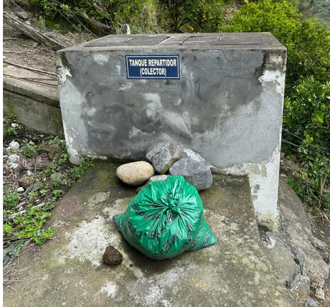
Figura 15. Tanque Repartidor (Colector). Fuente: Autor
