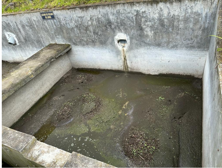
Figura 50. Lecho de secado de lodos afectado por la lluvia. Fuente: Autor
