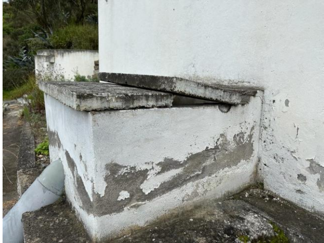
Figura 9. Deterioro de pintura y tapas de las cajas de revisión. Fuente: Autor
