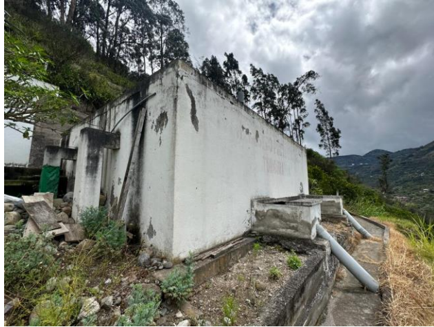
Figura 16. Tanque Séptico. Fuente: Autor
