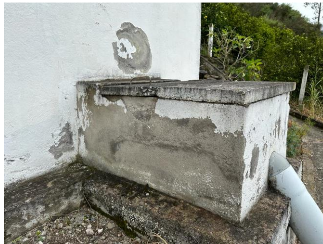
Figura 17. Cajas de Válvulas. Fuente: Autor
