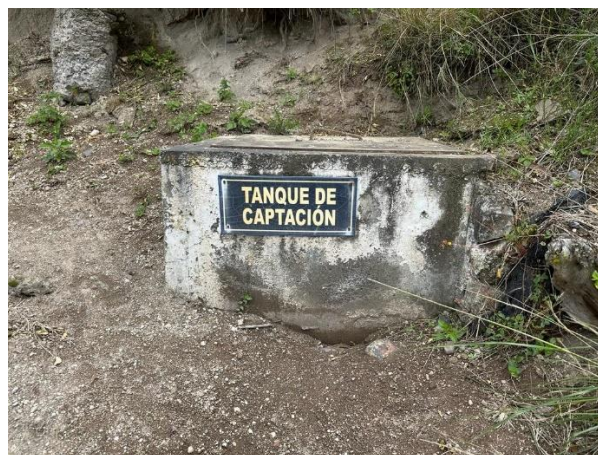
Figura 14. Tanque de Captación. Fuente: Autor
