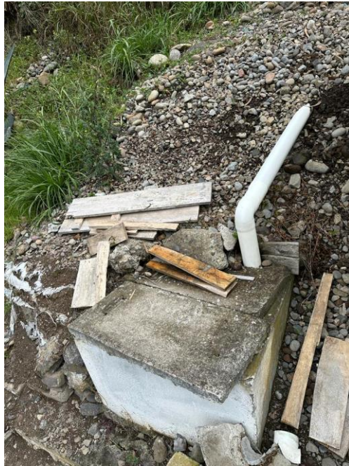
Figura 10. Escombros dentro de la PTAR. Fuente: Autor
