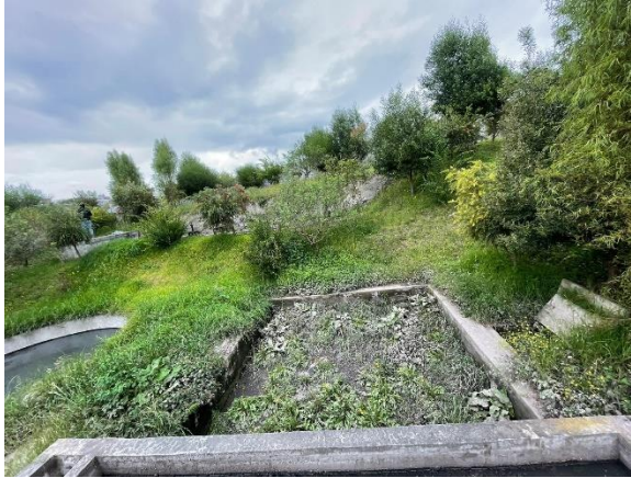
Figura 26. Lecho de secado de lodos
