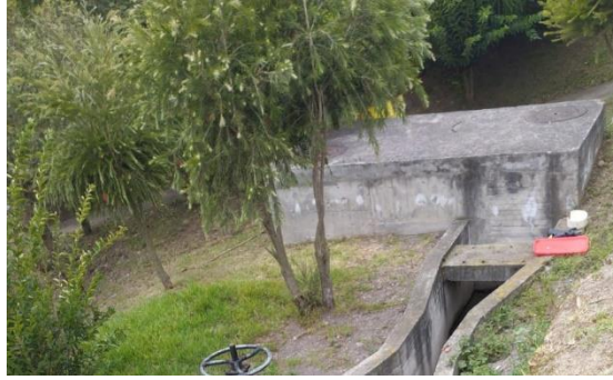
Figura 12. Tanque repartidor de caudales
