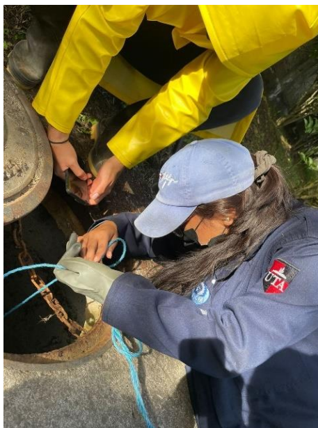
Figura 33. Medición de caudal de salida de la PTAR
