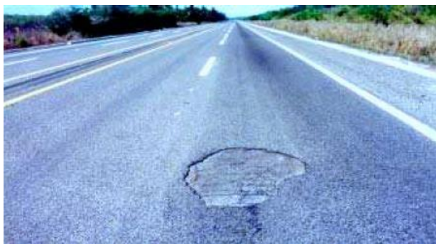
Figura 15: Desprendimiento de Agregados
