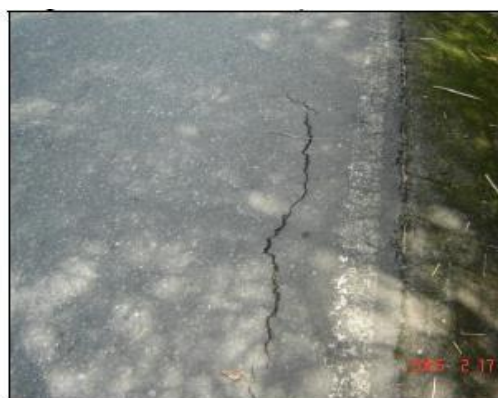
Figura 4: Grietas de Bordes
