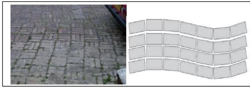
Figura 27: Desplazamiento de juntas
