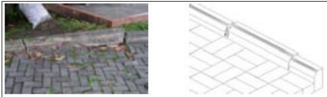
Figura 29: Fracturamiento de Confinamientos Externo
