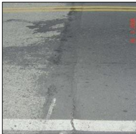
Figura 7: Grieta de Reflexión de Juntas
