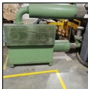
Figura 15. Turbina 2 extractora de polvo de la máquina ALETTI
