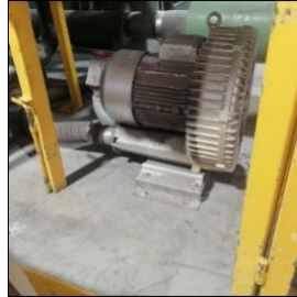
Figura 12. Turbina 1 extractora de polvo de la máquina STENI
