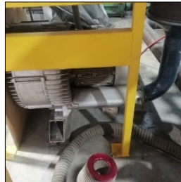
Figura 13. Turbina 2 extractora de polvo de la máquina STENI
