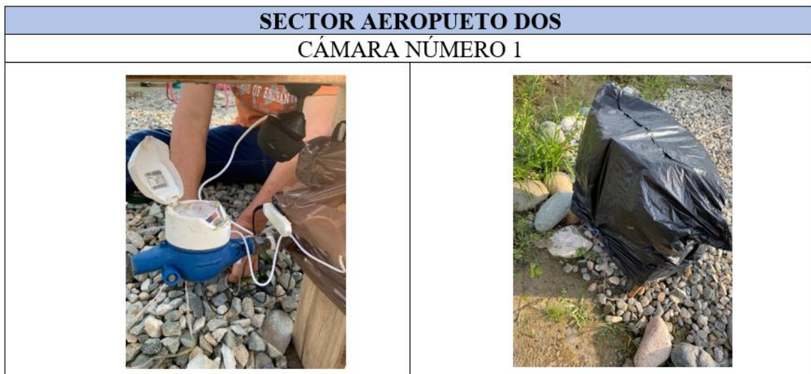
Figura 28. Instalación de cámaras sobre medidores seleccionados en los sectores de estudio.
