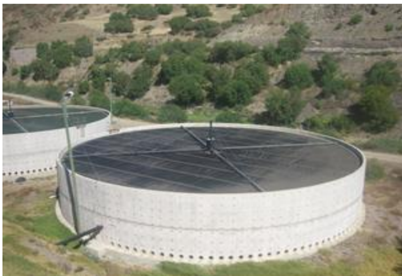
Figura 11. Vista general de un filtro percolador
