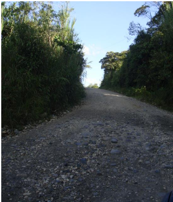
c.-Deterioro evidente de la capa de rodadura geométrico
