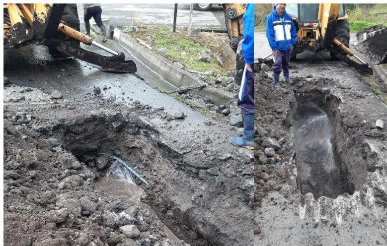
Imagen N.- 26: Fuga en tubería en el sector El Calvario
