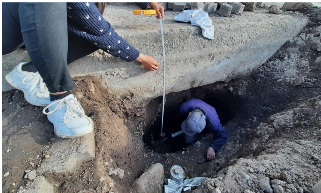
Inspección del estado de las tuberías del SDAP existente mediante una calicata excavada para realizar arreglos.
