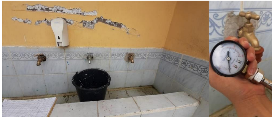
Imagen N.- 25: Insuficiente dotación de agua a la U.E. Pasa
