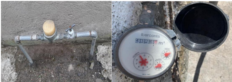
a) Medidor fuera de funcionamiento
