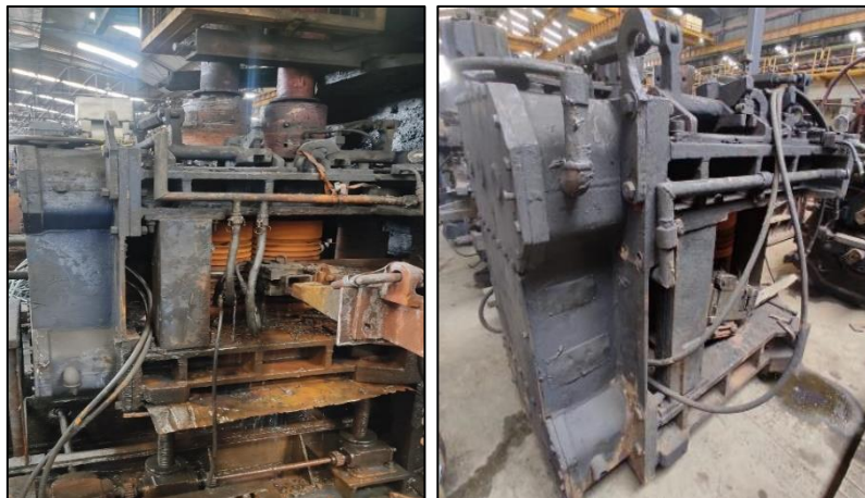
Figura 17. Caseta Danieli vertical 1 del tren de producción 1.
