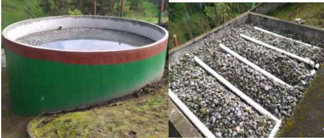
Figura 19. Estado del medio filtrante y FAFA
