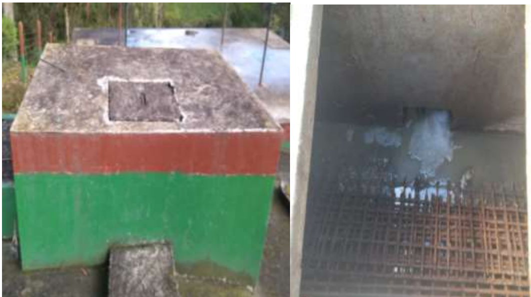
Figura 17. Estado del tanque repartidor
