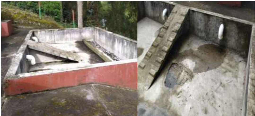
Figura 20. Estado del medio filtrante y FAFA
