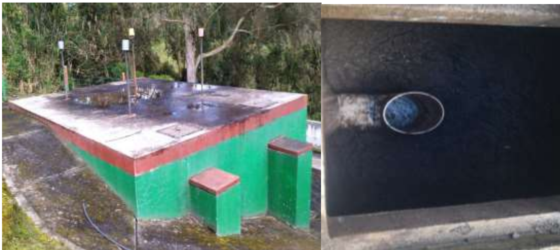
Figura 18. Estado del tanque séptico
