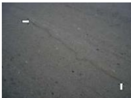
Figura 18. Fisura longitudinal y transversal
