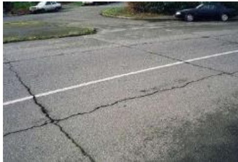
Figura 16. Fisura de reflexión de junta
