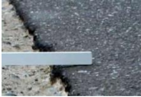
Figura 17. Desnivel carril – berma
