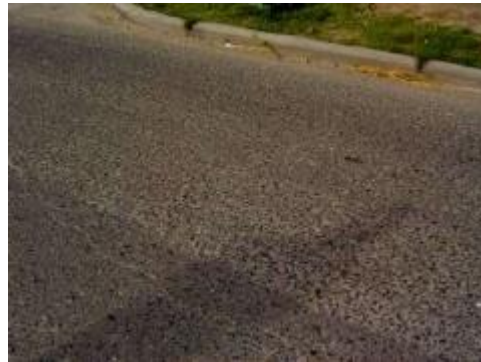
Figura 26. Desprendimiento de agregados
