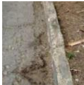
Figura 15. Fisura de borde
