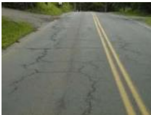
Figura 11. Fisura en bloque
