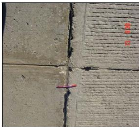
Figura N° 27: Deterioro del sello
