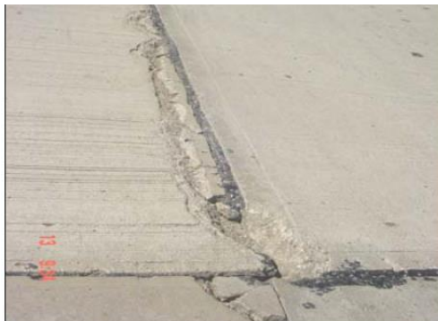
Figura N° 28: Desportillamiento en junta
