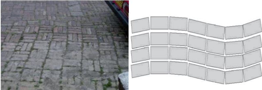
Figura N° 34: Desplazamiento de juntas
