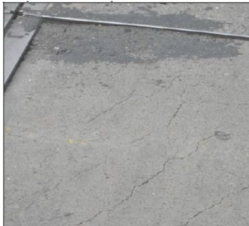
Figura N° 29: Fisuras ligeras de aparición temprana
