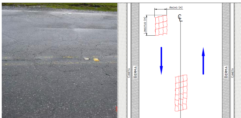
Figura N° 7: Fisura en Bloque
