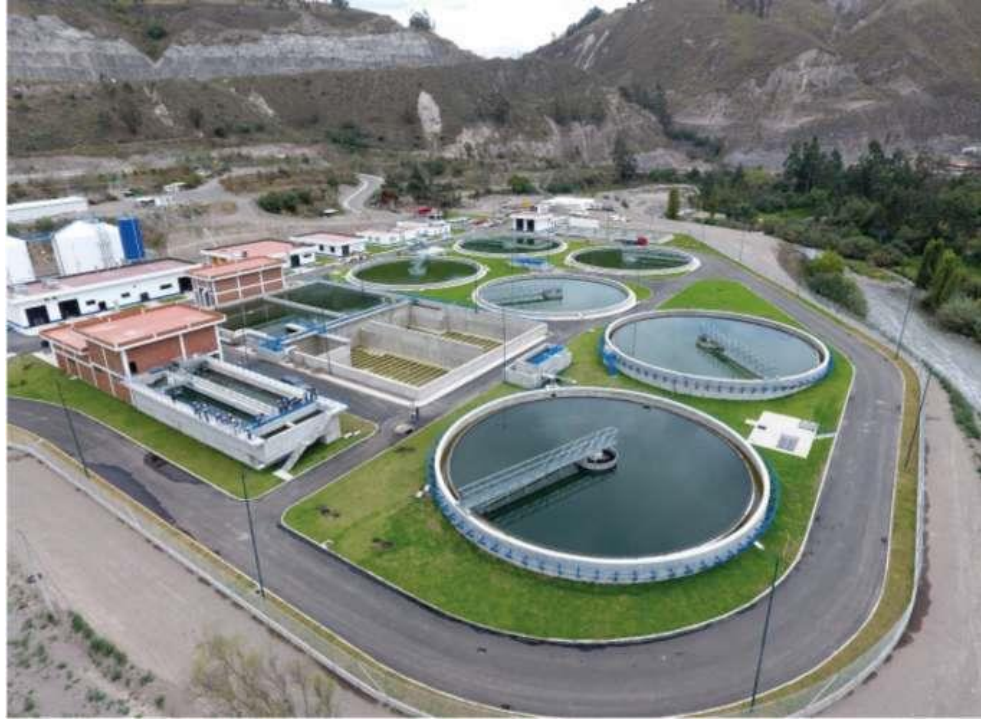
Figura 6: Planta de tratamiento de aguas residuales de Ambato - Tungurahua - Ecuador. Fuente: Diario La Hora. [31]
