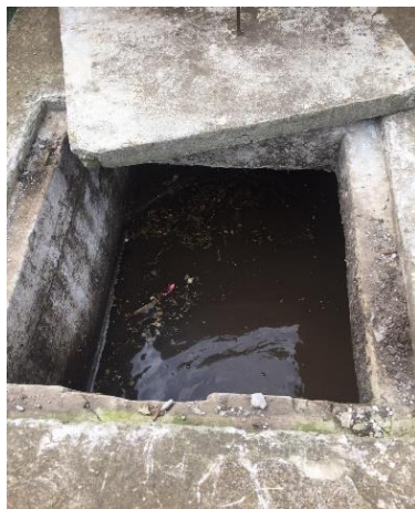
Figura 19: Tanque Séptico de la PTAR. Fuente: Autor.
