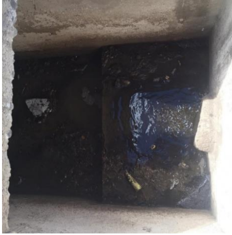
Figura 18: Tanque Repartidor de la PTAR. Fuente: Autor.
