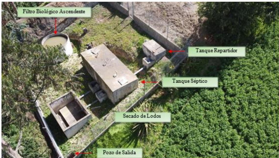
Figura 16: Estado actual de la PTAR de la comunidad Llimpe Chico. Fuente: Autor.
