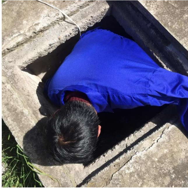
Figura 11: Toma de caudales de ingreso a la PTAR. Fuente: Autor.
