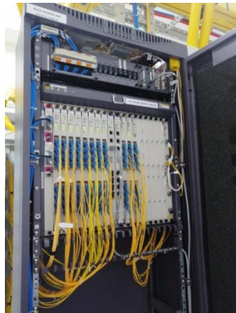
Figura 2.12 OLT tipo con tarjetería PON y uplinks. Fuente: El Autor
