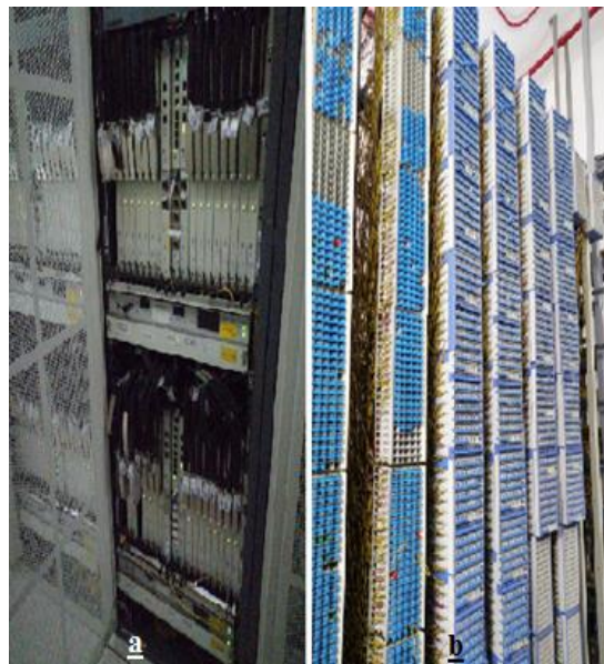
Figura 2.3 a) Equipo DSLAM b) regletas de interconexión con POTS. Fuente: El Autor
