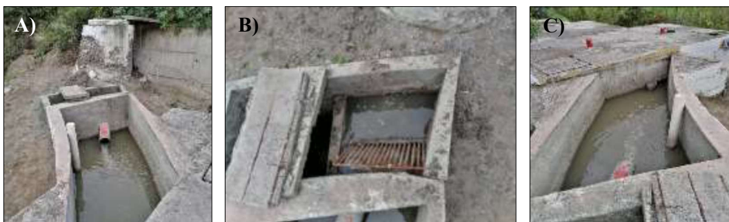
Figura 2. Etapa de ingreso del agua residual a la PTAR Mollepamba. A) Ingreso del agua residual a la PTAR Mollepamba (Aliviadero). B) Paso del agua a través de la rejilla metálica (Cribado). C) Flujo de agua luego de la rejilla hacia la fosa séptica para la PTAR Mollepamba.
