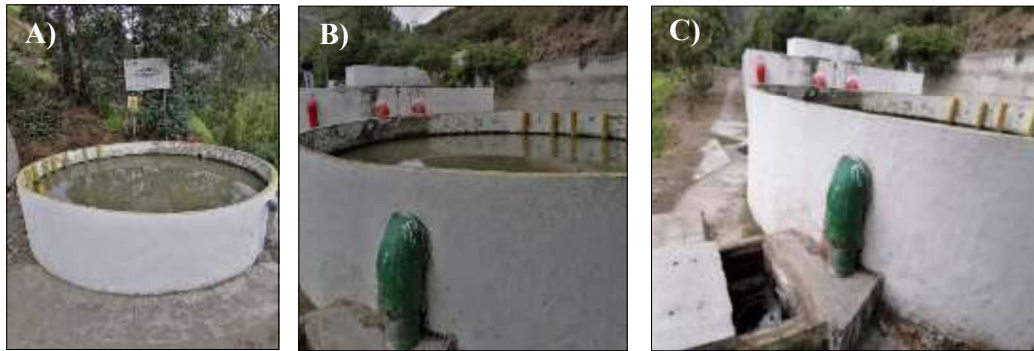
Figura 3. Etapa de reposo y salida del agua tratada hacia el río Pachanlica. A) Filtro percolar del agua tratada antes de desembocar al río Pachanlica. B) Conectores del paso de agua residual desde la fosa séptica hacia el filtro percolador. C) Salida del agua tratada hacia el río Pachanlica.
