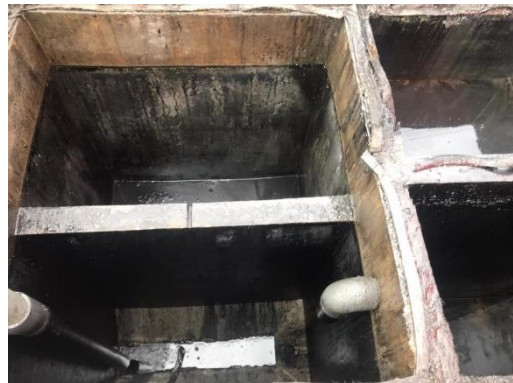
Limpieza del Trampa Grasas
