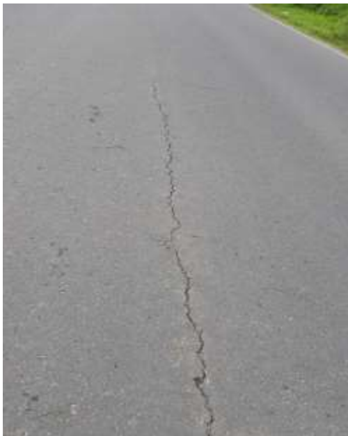
Identificación de fallas en el pavimento
