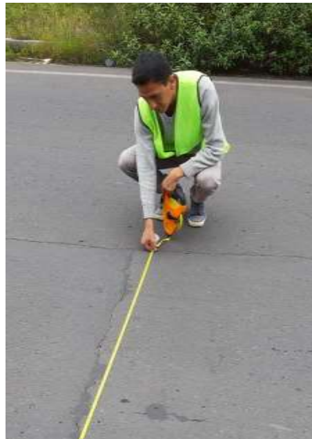
Medición de fallas en el pavimento
