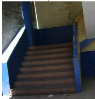
Fig13: Gradas mal construidas
