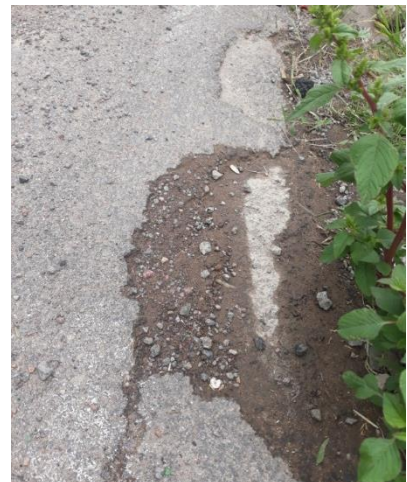
Fisura de borde severidad media
