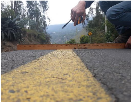
Ahuellamiento severidad baja
