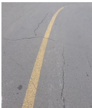
Grieta transversales y longitudinales
