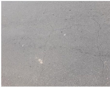
Fisuras de bloque severidad baja
