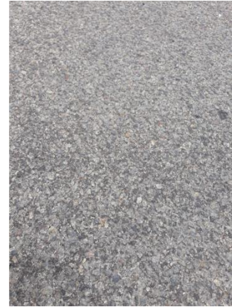
Pulimento de agregados severidad baja
