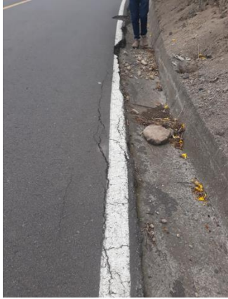
Fisura de borde severidad alta
