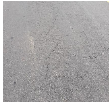
Pulimento de agregados severidad baja
