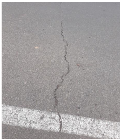
Grieta severidad media
