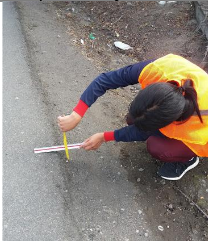
Evaluación de PCI falla Desnivel de berma
