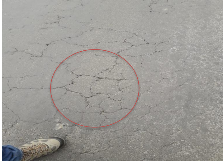
Figura 4. Piel de cocodrilo de nivel de severidad medio
