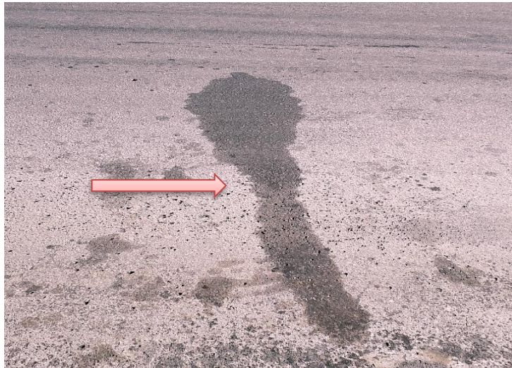
Figura 7. Exudación de nivel de severidad medio
