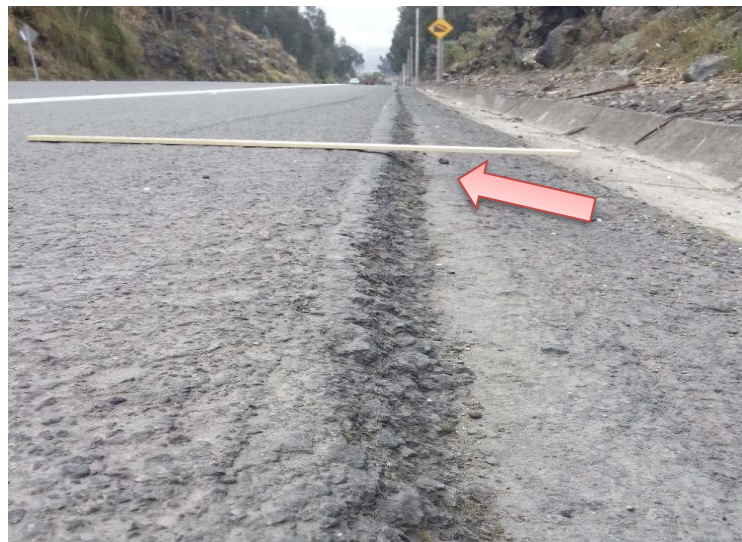
Figura 26. Desnivel carril-berma de nivel de severidad alto
