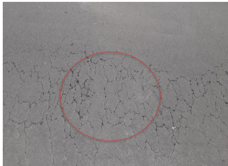
Figura 5. Piel de cocodrilo de nivel de severidad alto
