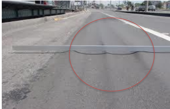
Figura 37. Ahuellamiento de nivel de severidad alto
