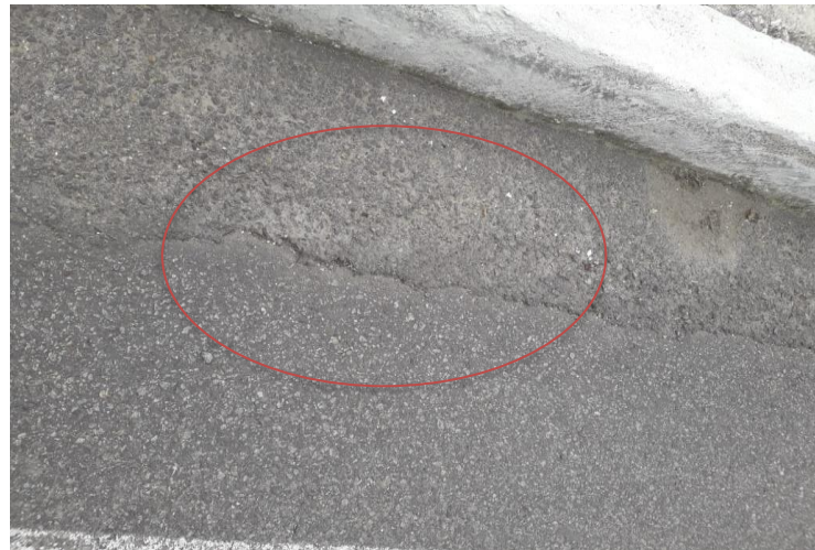
Figura 21. Fisuras de borde de nivel de severidad baja
