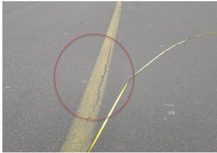
Figura 27. Fisuras longitudinales y transversales de nivel de severidad bajo
