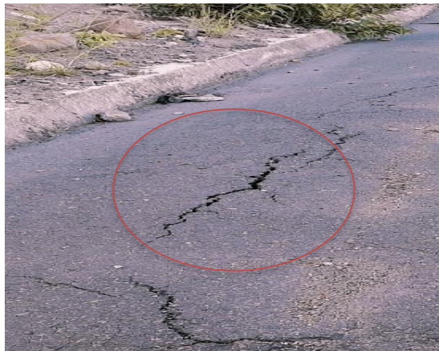
Figura 22. Fisuras de borde de nivel de severidad media
