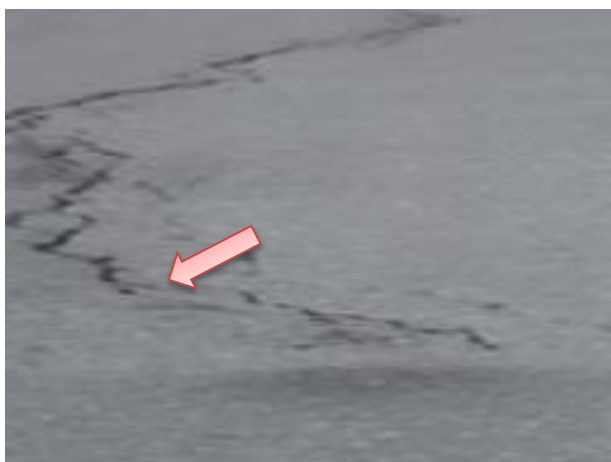
Figura 42. Fisura parabólica o por deslizamiento de nivel de severidad media
