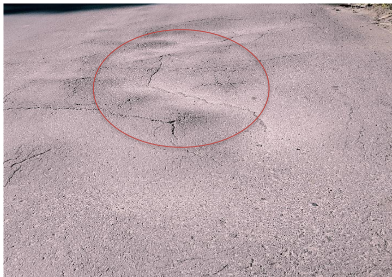
Figura 13. Abultamientos y hundimientos de nivel de severidad media
