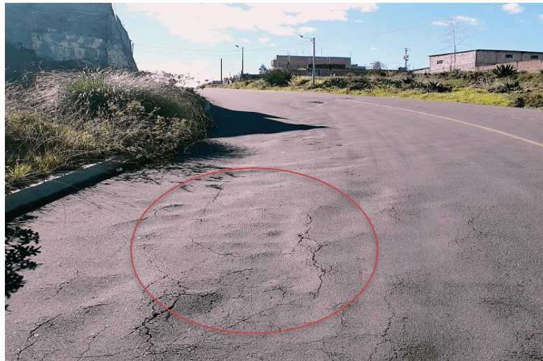
Figura 14. Abultamientos y hundimientos de nivel de severidad alta
