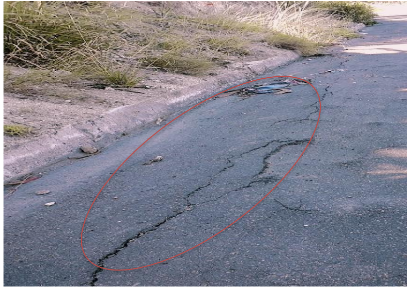
Figura 23. Fisuras de borde de nivel de severidad alto
