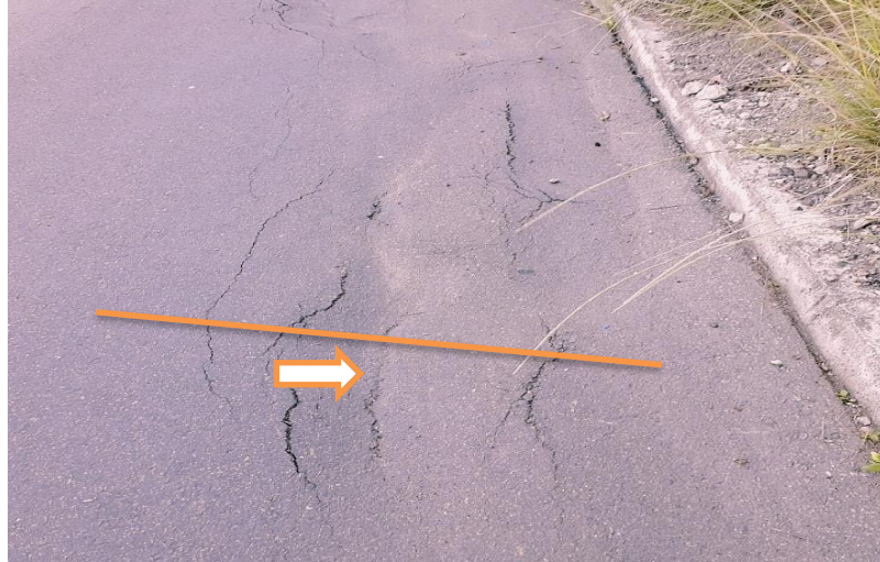
Figura 19. Depresión de nivel de severidad media
