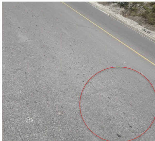
Figura 38. Desplazamiento de nivel de severidad baja
