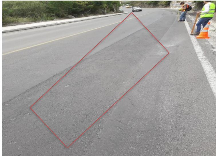
Figura 30. Parches y parches de cortes unitarios de nivel de severidad baja
