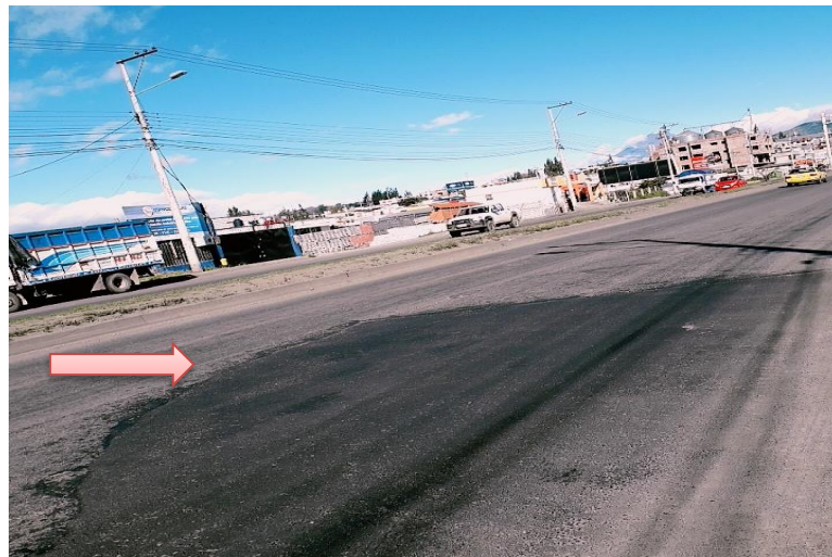
Figura 8. Exudación de nivel de severidad alto
