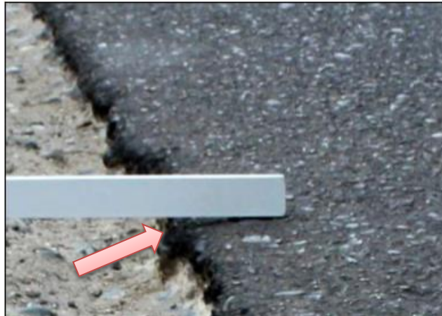
Figura 25. Desnivel carril-berma de nivel de severidad medio
