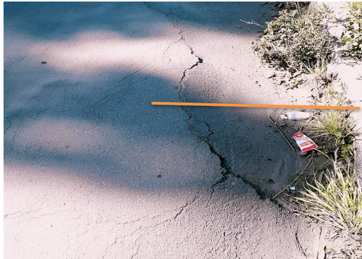
Figura 20. Depresión de nivel de severidad media
