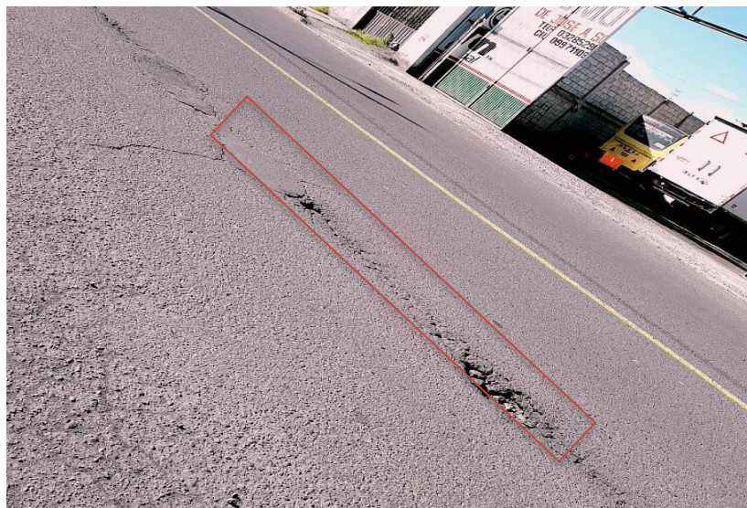
Figura 29. Fisuras longitudinales y transversales de nivel de severidad alta
