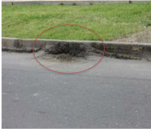
Figura 46. Hinchamiento de nivel de severidad alta
