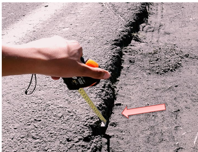
Figura 24. Desnivel carril-berma de nivel de severidad bajo
