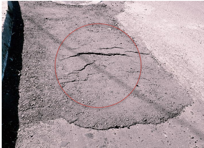
Figura 39. Desplazamiento de nivel de severidad media
