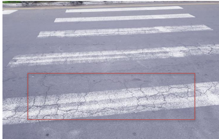
Figura 9. Fisuras en bloque de nivel de severidad bajo
