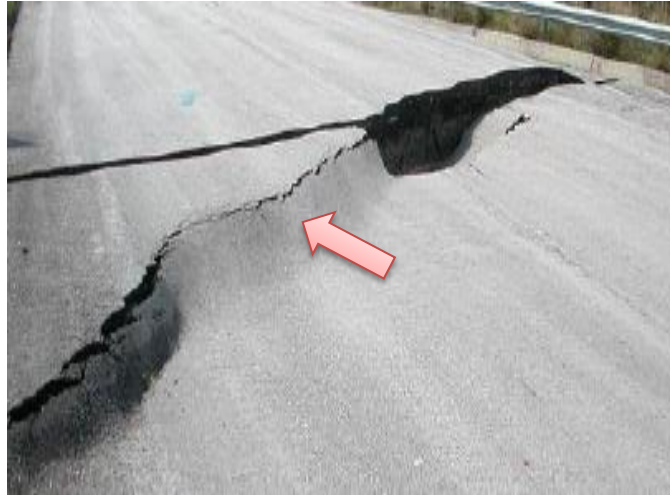
Figura 43. Fisura parabólica o por deslizamiento de nivel de severidad alta
