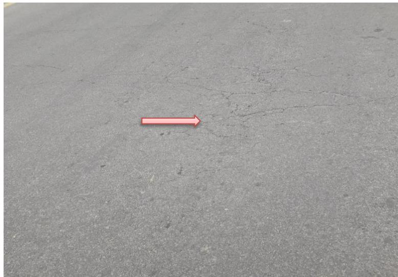
Figura 3. Piel de cocodrilo de nivel de severidad bajo
