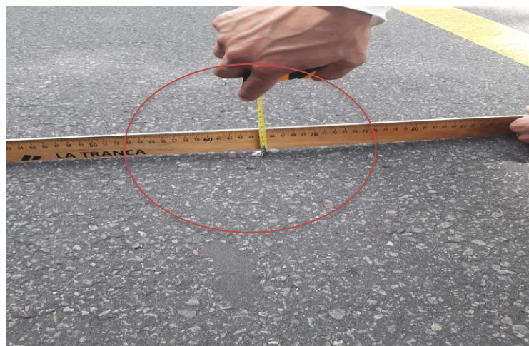
Figura 18. Depresión de nivel de severidad baja.
