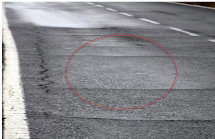
Figura 16. Corrugación de nivel de severidad media.
