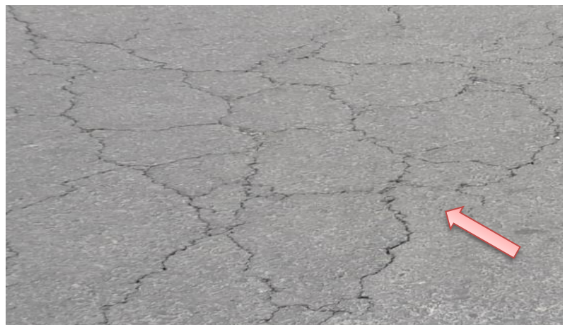
Figura 10. Fisuras en bloque de nivel de severidad media
