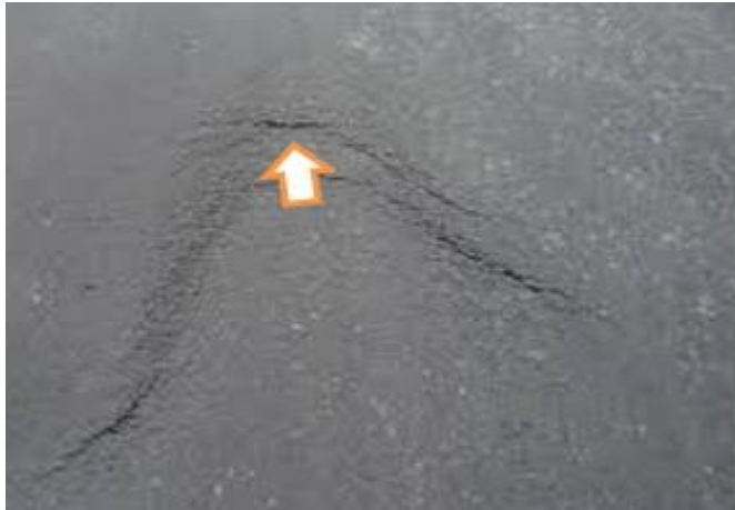
Figura 41. Fisura parabólica o por deslizamiento de nivel de severidad baja
