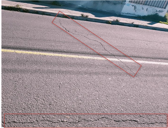
Figura 28. Fisuras longitudinales y transversales de nivel de severidad medio
