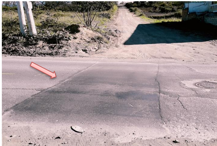
Figura 31. Parches y parches de cortes unitarios de nivel de severidad media
