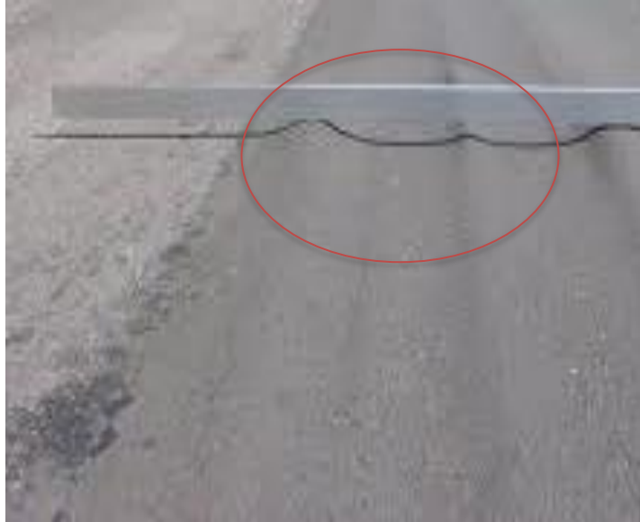
Figura 17. Corrugación de nivel de severidad alta
